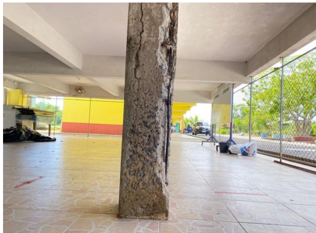
เสาอาคารเรียนที่มีความเสี่ยงถล่ม
