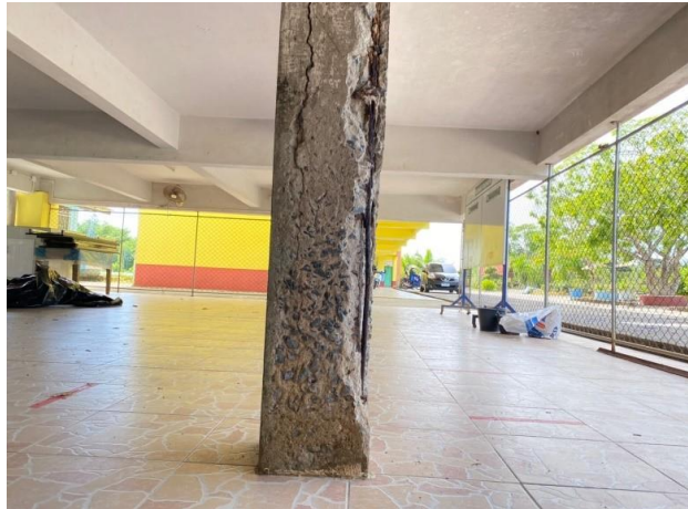
倒壊の恐れのある校舎の柱
