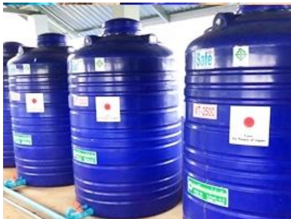
貯水タンク(2,000リットルx10台)
