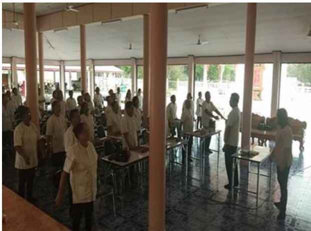
ศาลาเบริญญของวัดที่ใช้เพื่อทำกิจกรรมของผู้สูงอายุไม่มีผนังด้านข้างอาคาร จึงไม่สามารถใช้ได้เวลาอากาศร้อนมากหรือฝนตกหนัก
