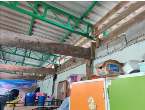
柱の老朽化や雨漏りが深刻
